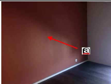
Photo n° PhA003 Localisation : Entrée; Dégagement; Placard 1; Chambre 1; Chambre 2; Séjour Ouvrage : 3 - Parois verticales intérieures - Murs et cloisons maçonnés Partie d'ouvrage : Enduit à base de plâtre lissé ou taloché Description : Enduit à base de plâtre lissé ou taloché
