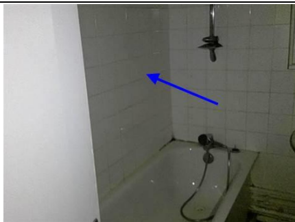
Photo n° PhA004 Localisation : Salle de bains Ouvrage : 3 - Parois verticales intérieures - Cloisons sèches (assemblées, préfabriquées) Partie d'ouvrage : Enduits à base de plâtre ou ciment projetés, lissés ou talochés Description : Enduits à base de plâtre ou ciment projetés, lissés ou talochés
