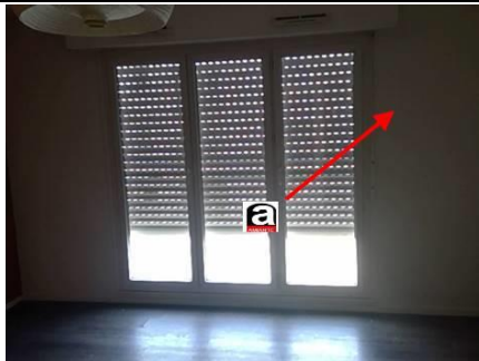
Photo n° PhA002 Localisation : Entrée; Dégagement; Placard 1; Chambre 1; Chambre 2; Séjour Ouvrage : 3 - Parois verticales intérieures - Murs et cloisons maçonnés Partie d'ouvrage : Enduit à base de plâtre lissé ou taloché Description : Enduit à base de plâtre lissé ou taloché
