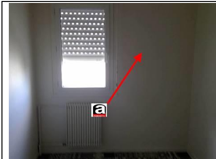
Photo n° PhA001 Localisation : Salle de bains; WC; Cuisine Ouvrage : 3 - Parois verticales intérieures - Murs et cloisons maçonnés Partie d'ouvrage : Enduit à base de plâtre lissé ou taloché Description : Enduit à base de plâtre lissé ou taloché
