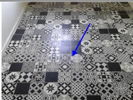
Photo n° PhA005 Localisation : Salle de bains; WC; Cuisine Ouvrage : 5 - Planchers et planchers techniques - Revêtements de sols Partie d'ouvrage : Dalle de sol Description : Dalle de sol
